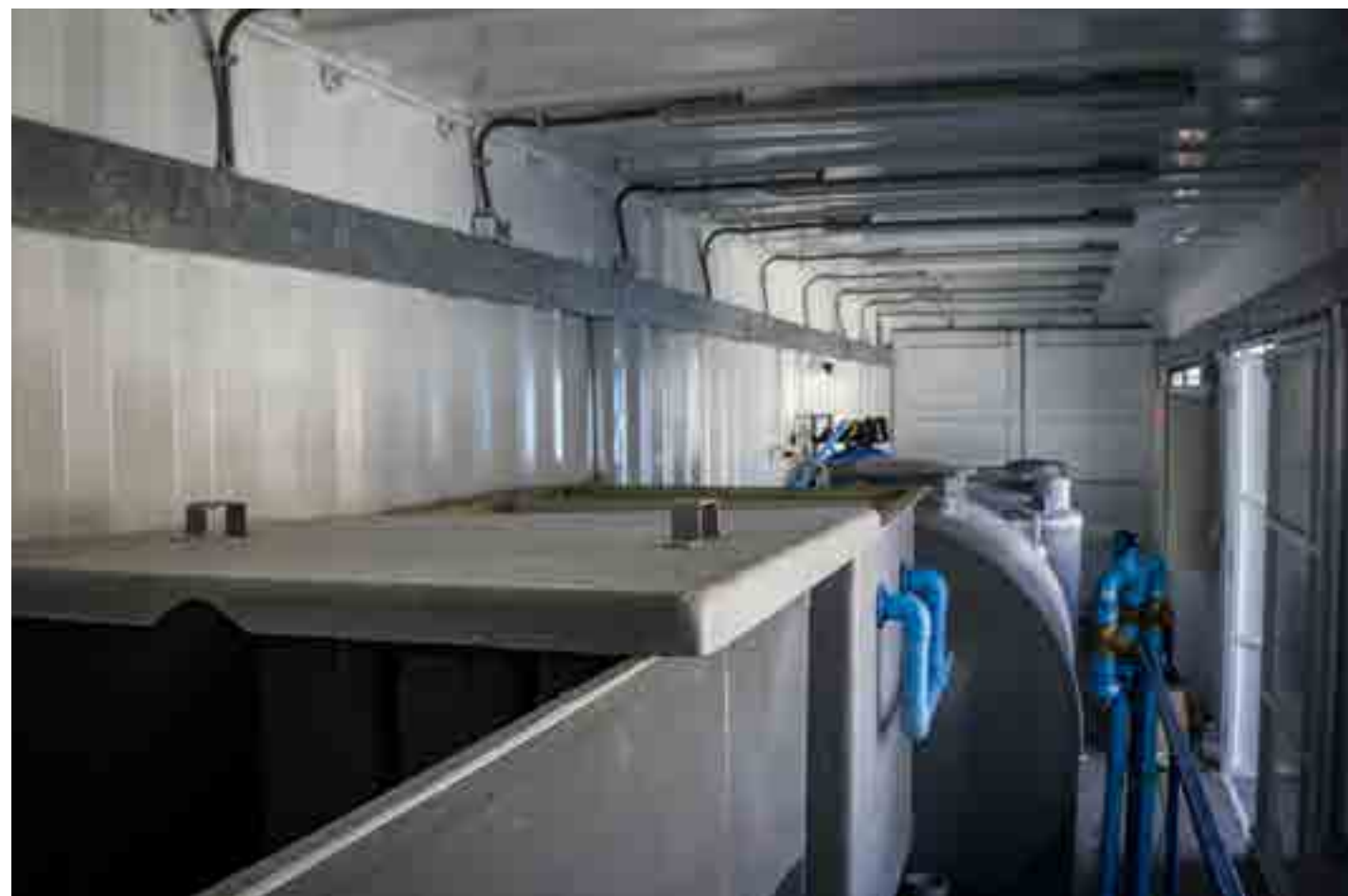
Planta de tratamiento de RILEs.
